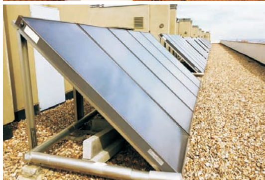
Instalación sobre tejado y terraza plana.
