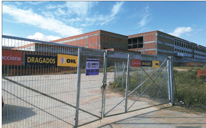
Después de la presentación de García-Page, las puertas del hospital seguían cerradas.
