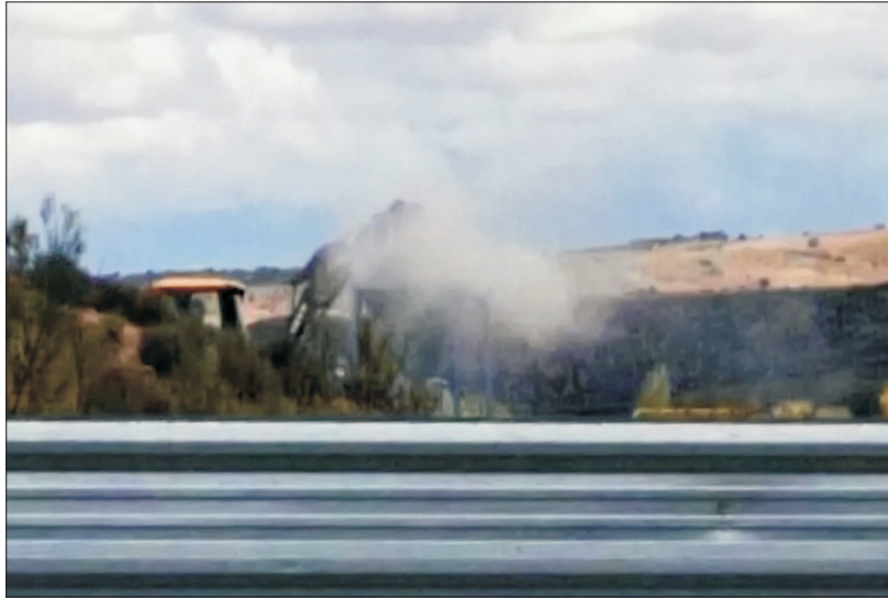
La nube de polvo fue evidente durante toda la retirada del amianto.
