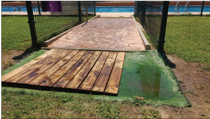
La obra mal realizada con el desagüe en alto ha resultado una chapuza que habrá que demoler.
