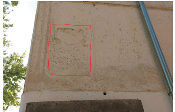
Aquí hubo una placa que el calor desprendió.
