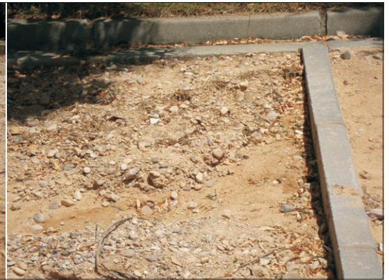
El bordillo no ha evitado el arrastre de tierras.
