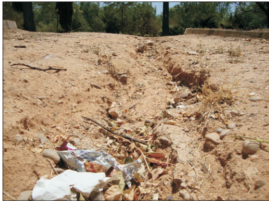
A cada lluvia vuelven a surgir pequeñas torrenteras.
