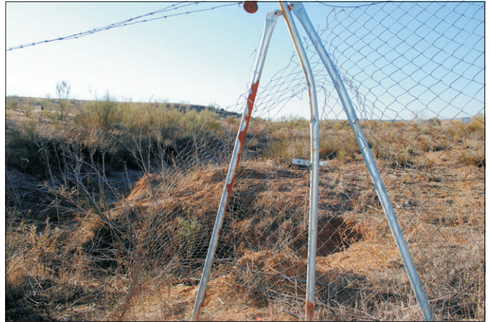
Una alambrada corta transversalmente el cauce del arroyo.
