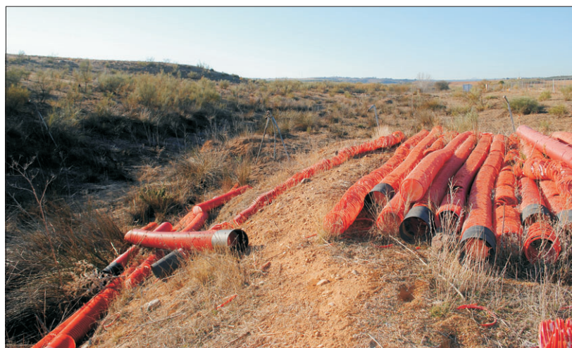
Restos de canalizaciones invaden el cauce.
