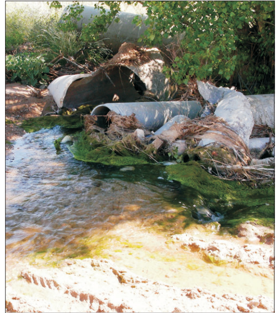
El problema del amianto sigue sin resolverse.
