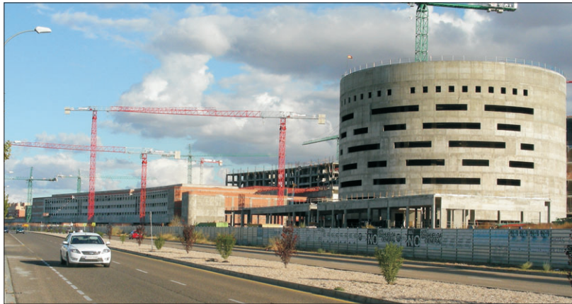
Obras paralizadas del nuevo hospital.
