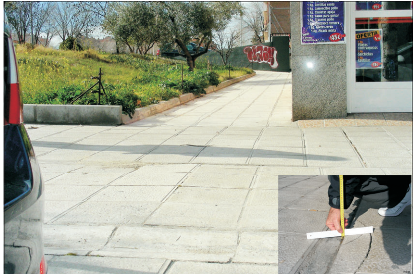
A esta altura de Guadarrama entre Alberche y Valdemaría se diseñó el paso de peatones, como muestra la zona sombreada en el centro de la foto, ahora que se ha decidido no realizarlo queda un escalón de dos cm. como muestra el detalle de la foto pequeña.
