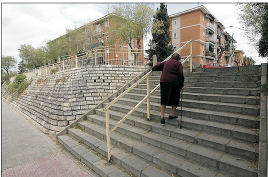
La rampa de la calle Tiétar sigue sin construirse.
