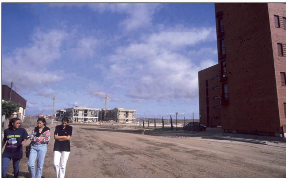
Construcción del Campus Universitario de Ciudad Real. Fotografía de José Luis para Bisagra , 246 (27-9-1992), p. 44. Centro de Estudios de Castilla-La Mancha (Universidad de Castilla-La Mancha), Archivo fotográfico de la revista Bisagra .
