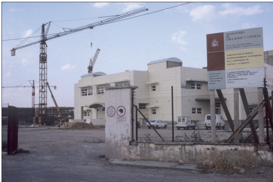
Antonio Fernández Alba, Facultad de Químicas (en construcción), c. 1990. Centro de Estudios de Castilla-La Mancha (Universidad de Castilla-La Mancha), Archivo fotográfico de la revista Bisagra .
