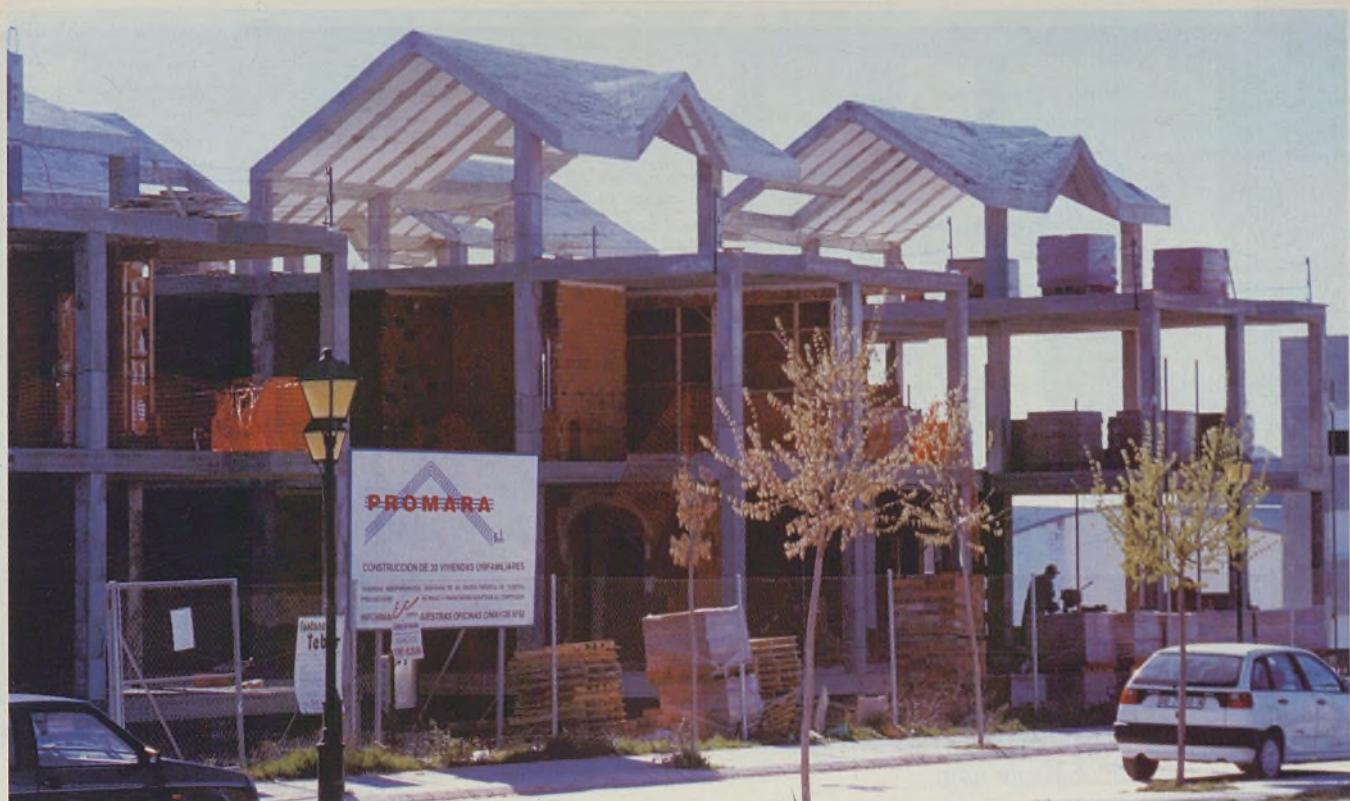
Construcciones sin licencia en el Alto de los Molinos
