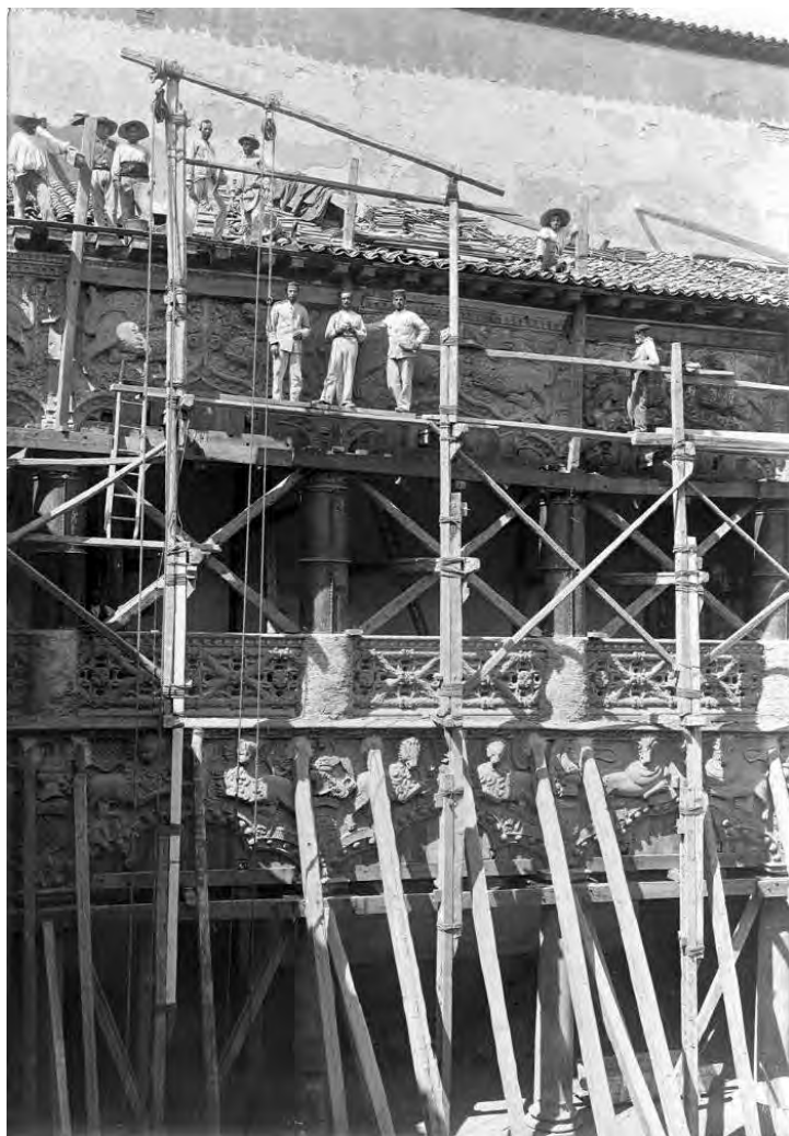
Figura 3. Apuntalamiento en el Patio de los Leones. Hacia 1911. Archivo Militar de Ávila. Cuerpo Facultativo de Ingenieros.
