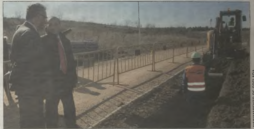
A PIE DE OBRA. El alcalde y el concejal de Medio Ambiente visitaron las obras
