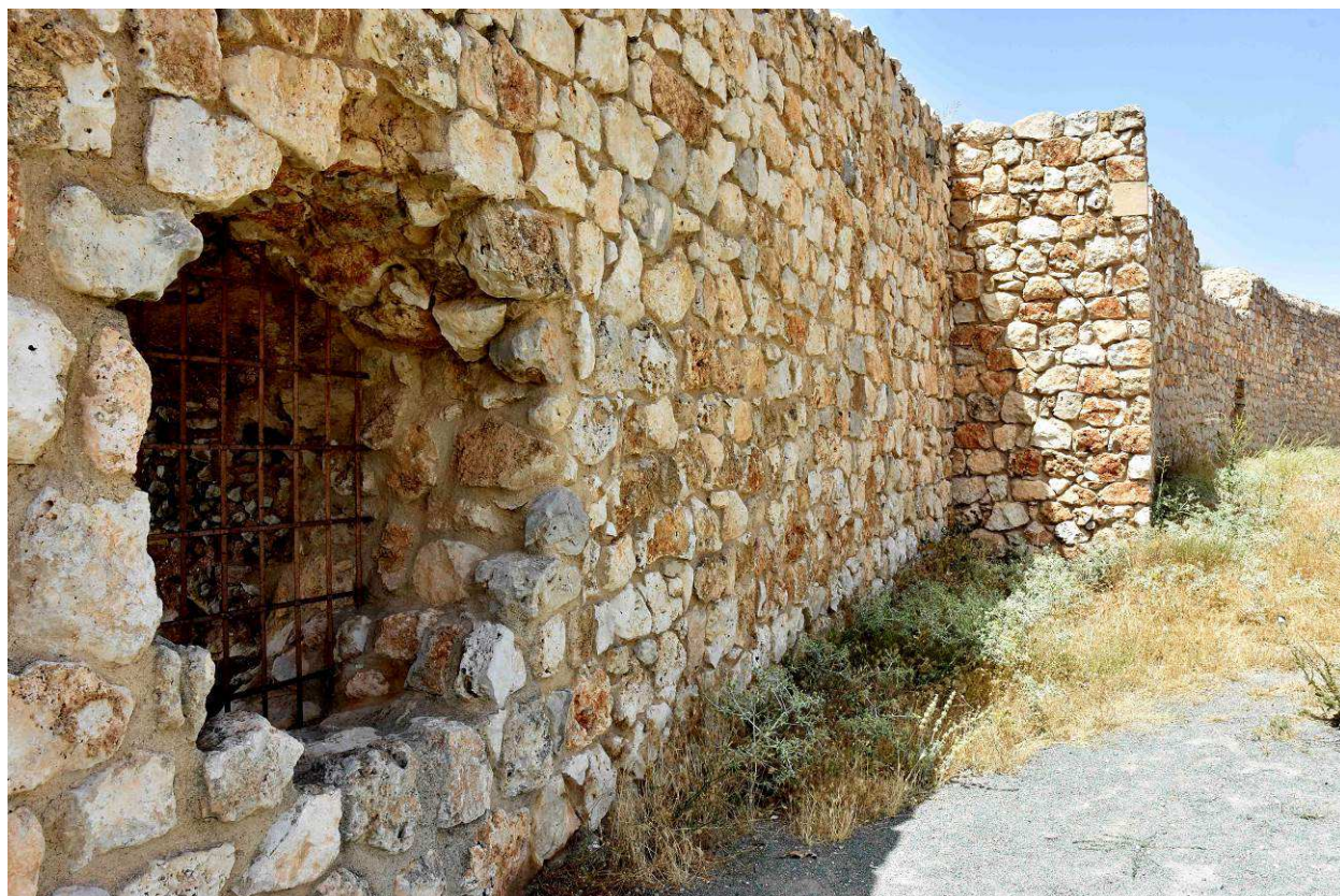
Panorámica de la muralla de Atienza junto al primer agujero cerrado con reja de hierro
