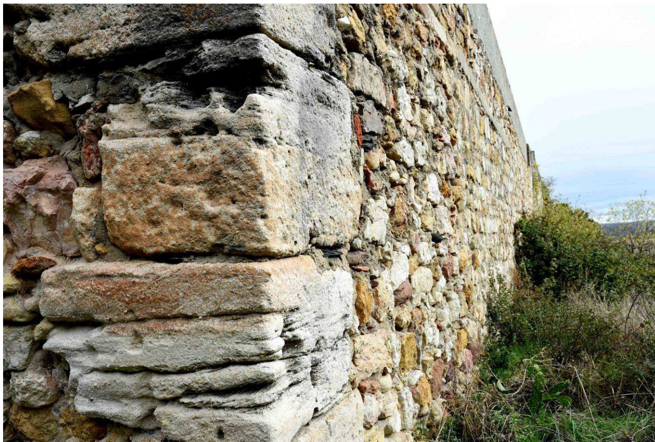
Elementos constructivos muy deteriorados
