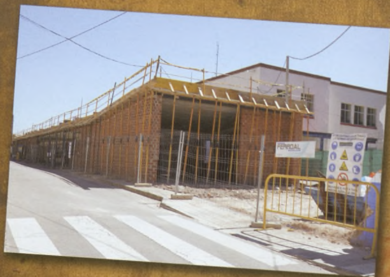
7. Las obras del colegio San Isidro, paradas por impagos del adjudicatario
