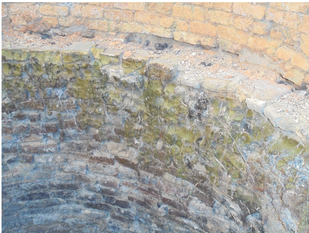
Imagen IV. Evidencias de proceso de “vitrificación” en ladrillos del horno.
