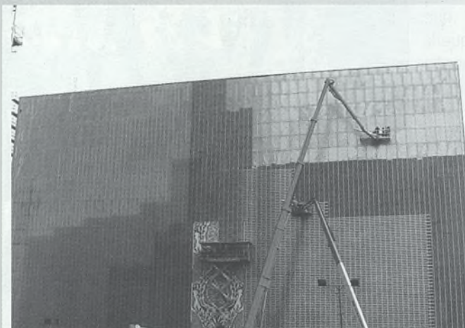
Un momento del proceso de instalación de algunos de los azulejos del mural. A la derecha, los ceramistas que han hecho posible la obra.
