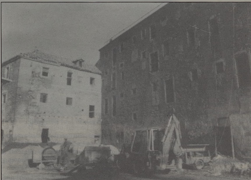
Algunos edificios necesitan de reparaciones para seguir "viviendo".
