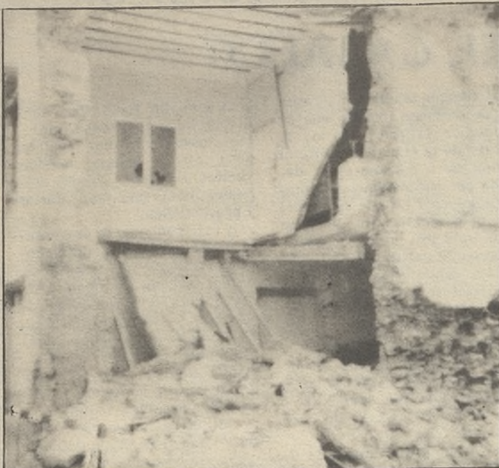
Aspecto de la casa de María Rabadán, tras el primer hundimiento hace dos meses
