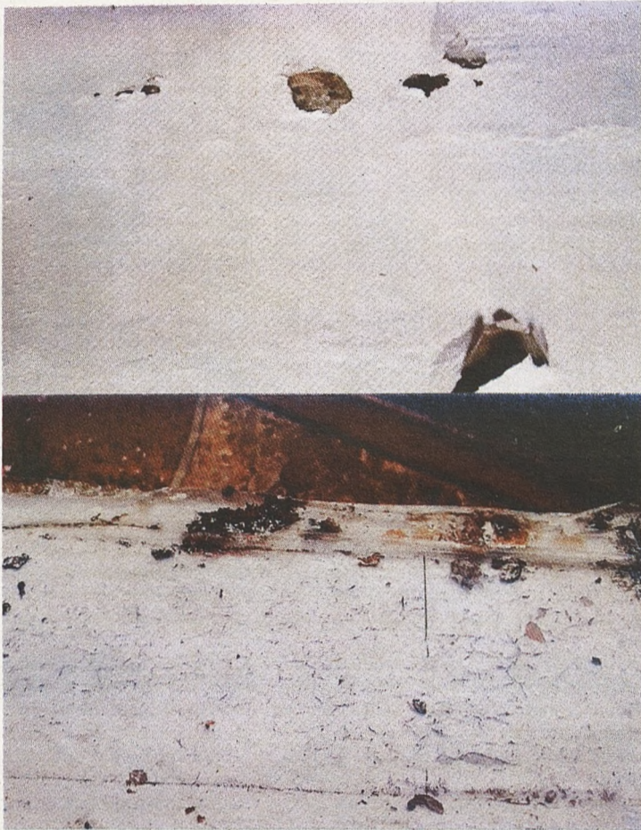
Arriba, las goteras se extienden por la techumbre y paredes de la vivienda. Abajo, excrementos de las palomas que han anidado en el piso desocupado
