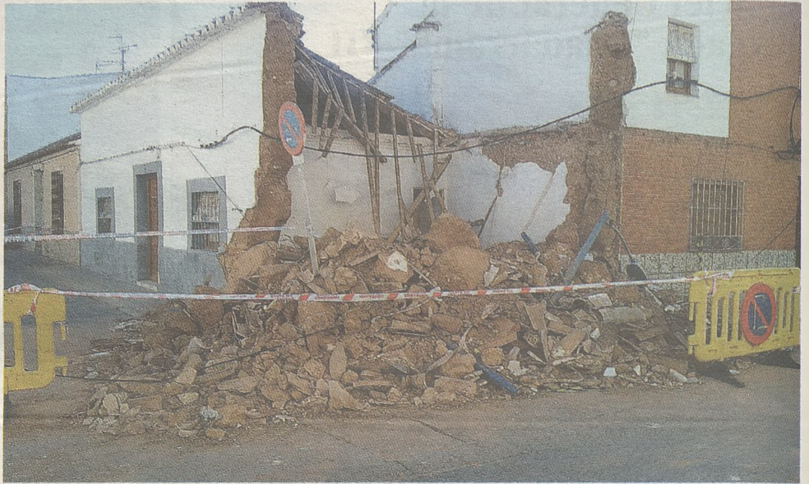
Aspecto del derrumbe de la casa situada en la esquina de Salida de los Llanos y Amparo
