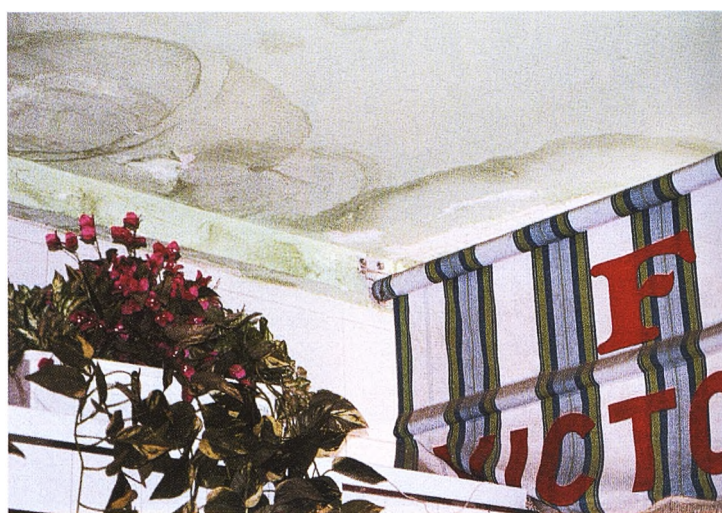
La precariedad de las instalaciones, tanto por dentro como por fuera, también es evidente. Algunos puestos sufren goteras e incluso grietas.
