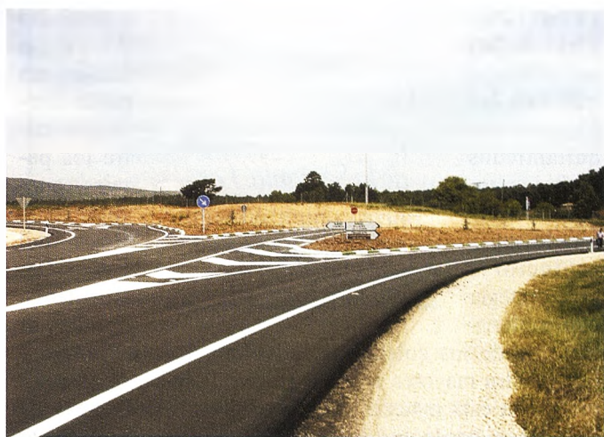
Cruce construido entre el Caserío de Embid y 'El Chantre' para enlazar la Variante Noroeste con la CM-2105.
