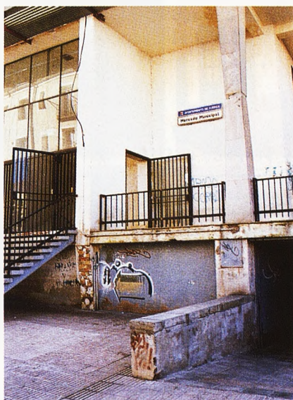
Aspecto del estado del edificio del Mercado Municipal.
