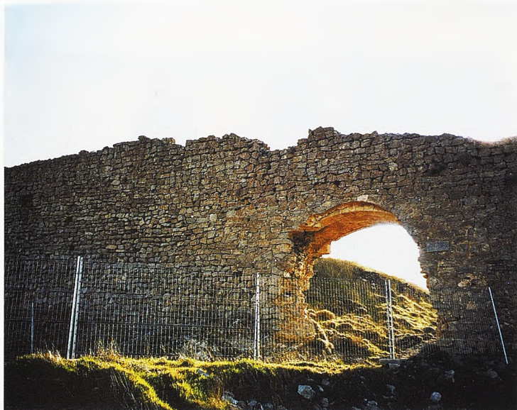
Puerta de la Calzadilla. Muy degradada, con peligro inminente de colapso.
