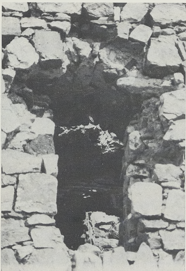
N.º 13. Ventana que ilumina el piso superior. Obsérvese el ladrillo empleado bajo el arranque del arco.
