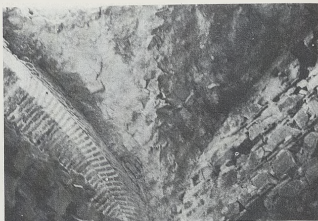
N.º 18. Arranque del arco de ladrillo y de la bóveda. Se ve claramente la arista. Obsérvense las hiladas de piedra y ladrillo del muro.
