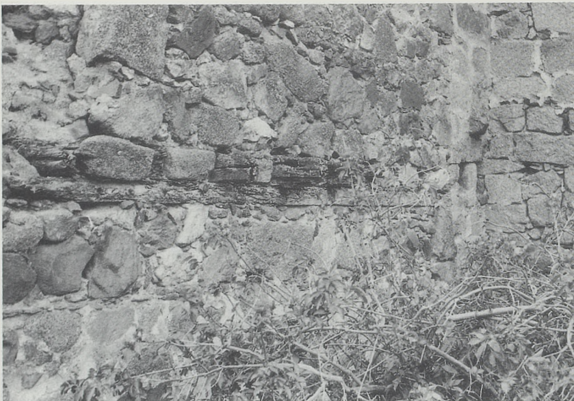
Fig. 6. Mechinales y extremos de las vigas en el interior de la torre, 1988
