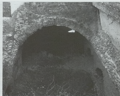
Rotura de una bóveda del subterráneo de Castronuevo. A un lado el parapeto de la barrera y al otro el arranque del castillo
