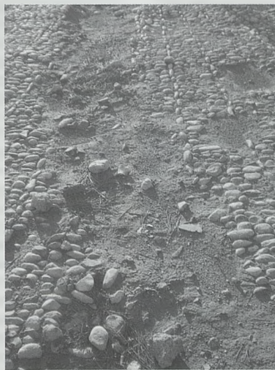
Fig. 6 Ejemplo del estado de conservación del pavimento
