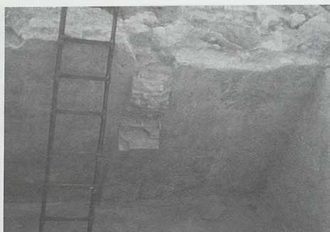
Fig. 7 Ejemplo del estado de conservación del aljibe
