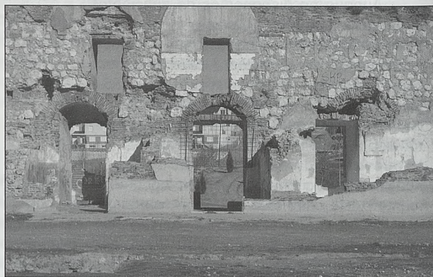
Muralla oriental vista desde el interior. Los tres arcos de ladrillo pertenecen al salón oriental que se abría al barranco del Alamín
