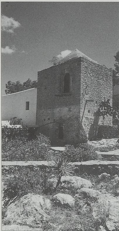
Torre de ca'n Maciá. San José. Conserva su cubierta piramidal a cuatro aguas.
