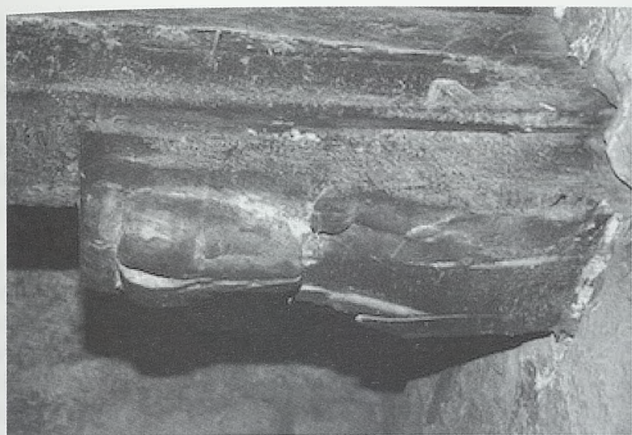
Fig. 6. Palacio de Equisoain: ménsula de madera de la torre
