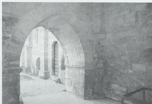
Interior de la torre sudoccidental superviviente. Planta baja y restos de columnitas, capiteles y arcos de sustentación de la bóveda. Arco de comunicación con el claustro y la iglesia. Autor Javier Martínez de Aguirre
