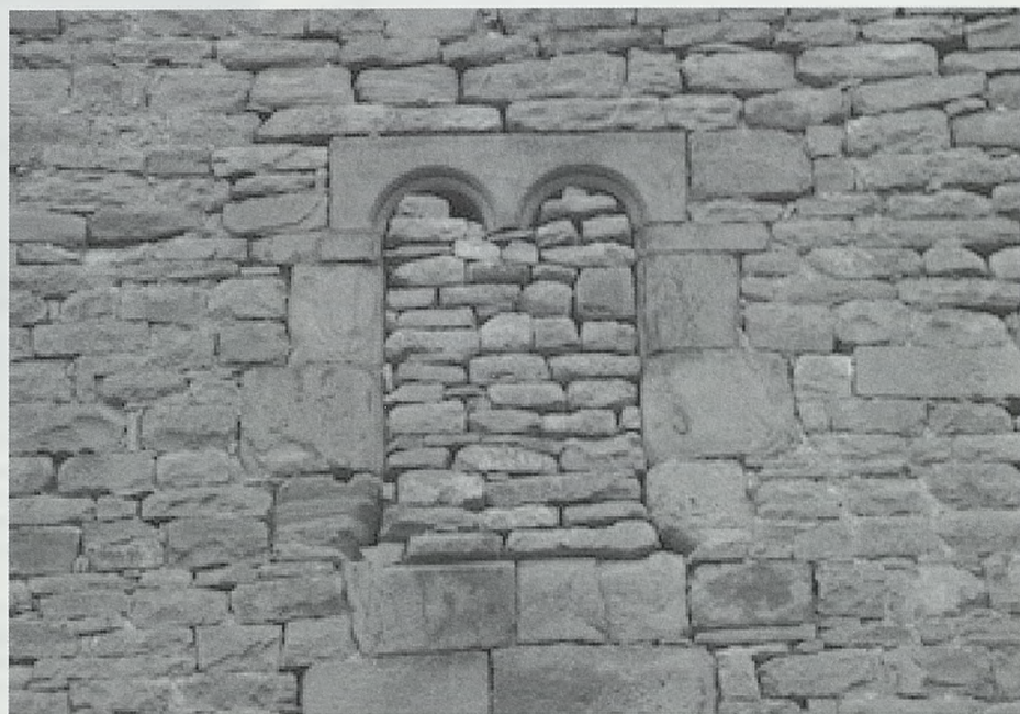
Fig. 11. Palacio de Equisoain: ventana de la planta noble (sala occidental) antes de la rehabilitación
