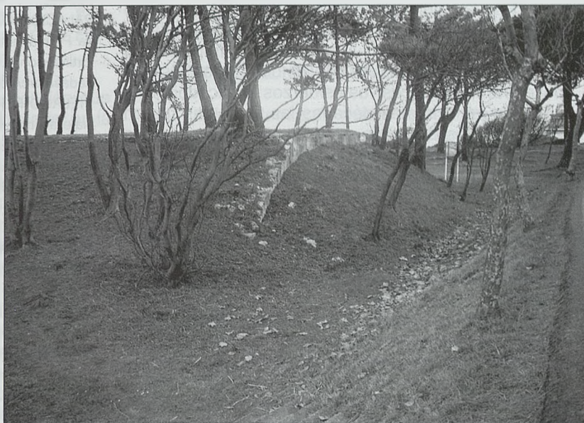
Fig. 16. Estado actual del través de hormigón de la batería de Sandoval (Fotografía R. Palacio)
