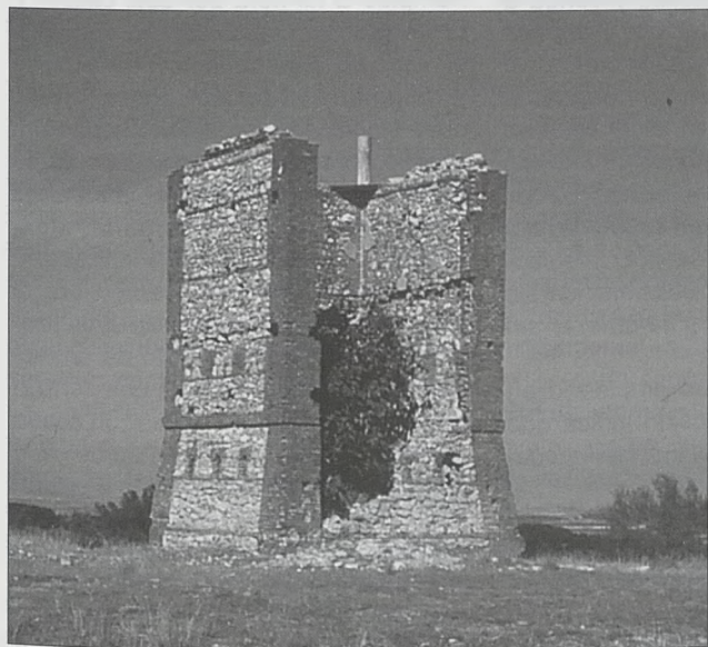
Torre del Campillo, en Arganda, con su pared sur derrumbada
