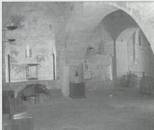
Fig. 6. Interior de la nave románica de la iglesia del castillo. Se aprecian las sucesivas ampliaciones
