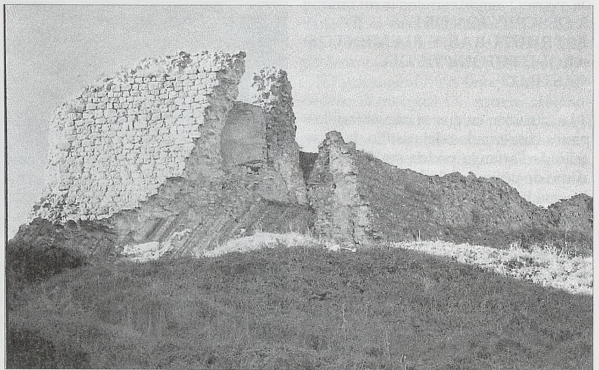
Vista de la zona este, donde podemos apreciar la sobreposición de muros, así como su aparejo constructivo
