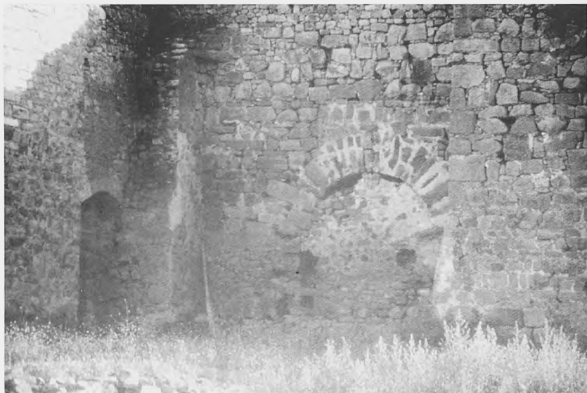
Fig. 11.- Arco de medio punto, con dovelas estrechas enjarjadas, en puerta recta simple flanqueada por dos torres (Recinto "A", Trujillo, Cáceres).
