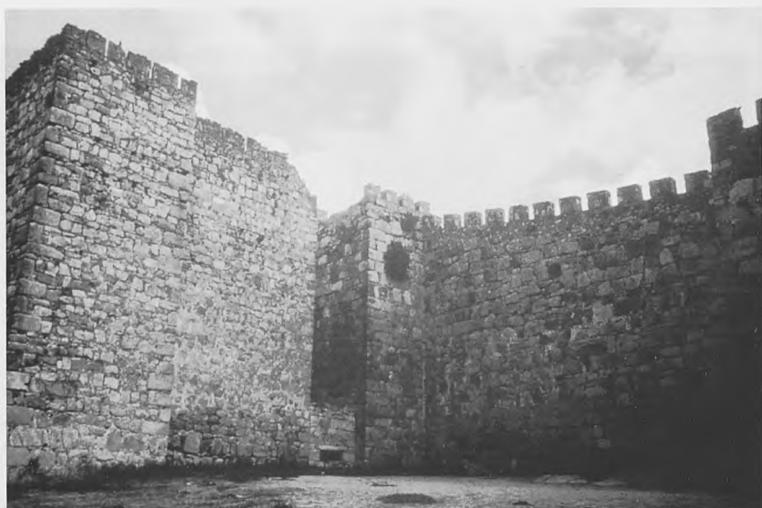
Fig. 43.- Vista del recinto de muros con albarranas, mostrando las zonas de fractura de sus pontezuelas respecto al lienzo principal. (Recinto "B", Castillo de Trujillo, Cáceres).
