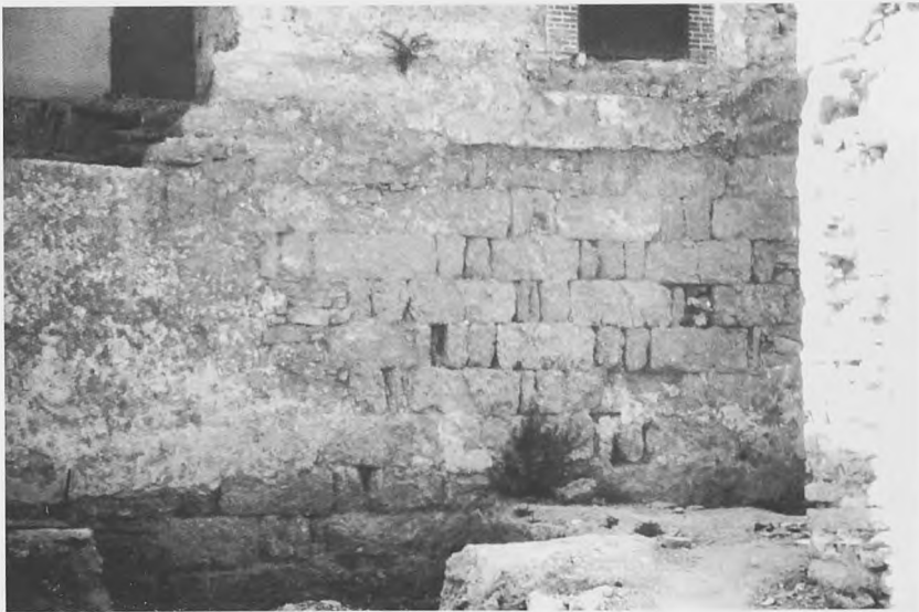
Fig. 9.- Detalle de aparejo con paso de dos a tres tizones (967 d.C.) (Castillo de Tarifa, Cádiz).
