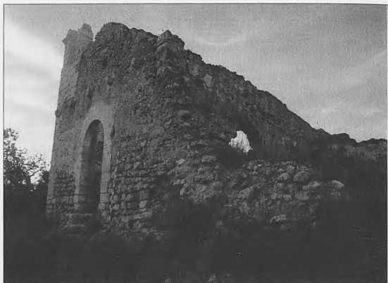
Ermita de San Miguel de Corbera adosada a los restos de la antigua torre de vigilancia (Valencia)
