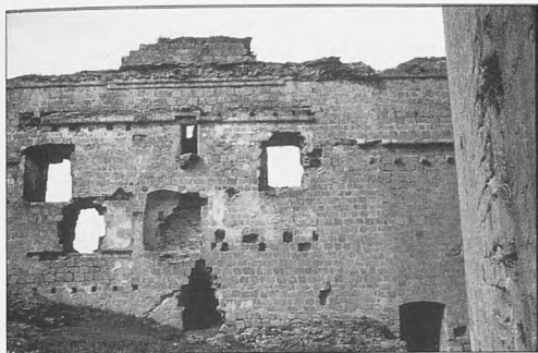
Lám. 3 Detalle de la cara interior del lienzo norte, con los restos del alero corrido, roto para la construcción de una crujía durante la fase de reformas.
