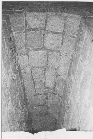
Lám. 12A Detalle del aparejo original del intradós de una de las aspilleras que iluminan las estancias inferiores de la torre del homenaje.
