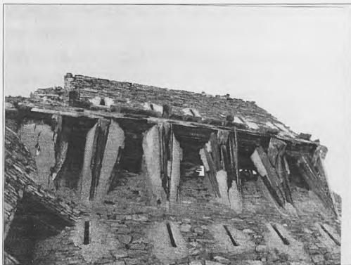
Lám. VI.b: Vista exterior del ala norte de los mata- canes del cuerpo oeste
