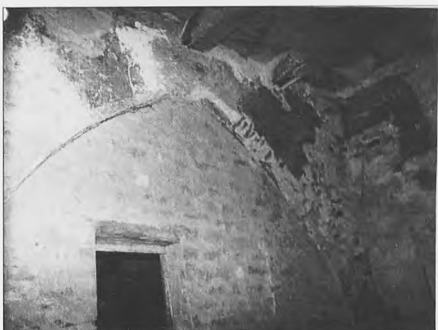
Lám. III.a: Arco diafragma de la planta baja de la crujía A y techumbre
