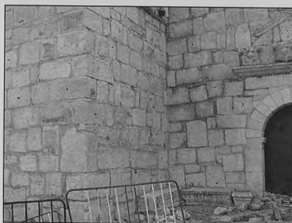
Foto 36. Le Kef, muros bizantinos
