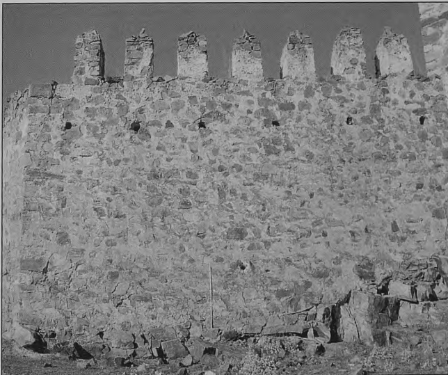
Figura 34 Castillo de Torrijos de la Cañlada: vista interior de uno de los muros de los lienzos del muro norte (mampostería de cal) con vigas de madera
