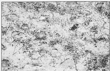
Foto 5 Iglesia de Enix. Detalle del afoscado de las fachadas
