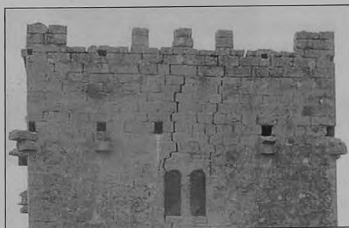
Figura 29 Castillo de Yéquera: zona alta del costado oriental de la torre principal
