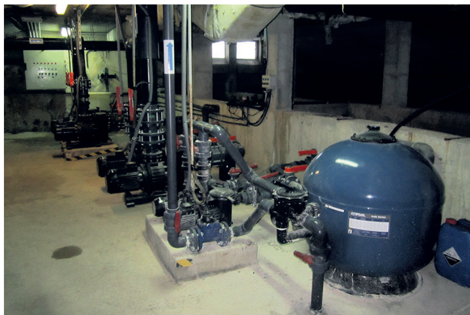
SALA DE MÁQUINAS DE LA PISCINA DE LOS LLANOS / M. G.
