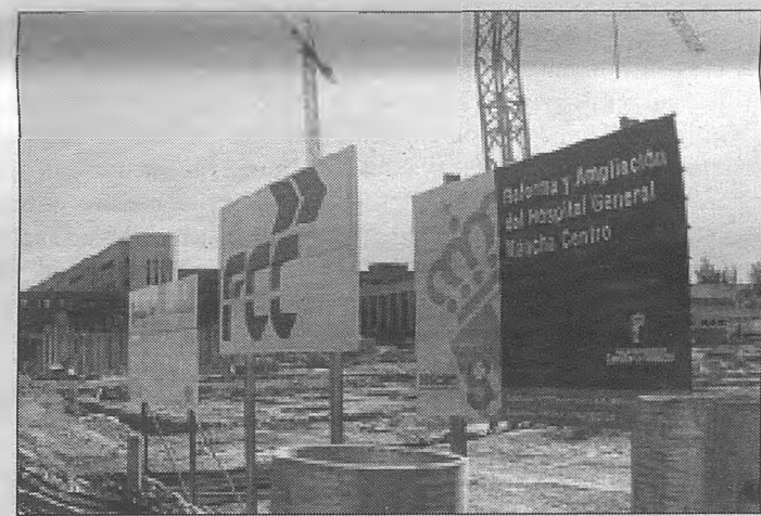
Foto: Sonia Morales Las obras ampliación y reforma del Hospital General 'La Mancha Centro' de Alcázar de San Juan, continúan a buen ritmo y cumpliendo los plazos previstos.
