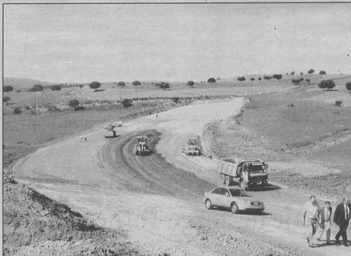
Imagen de archivo de las obras de la carretera entre Arroba y Horcajo.
