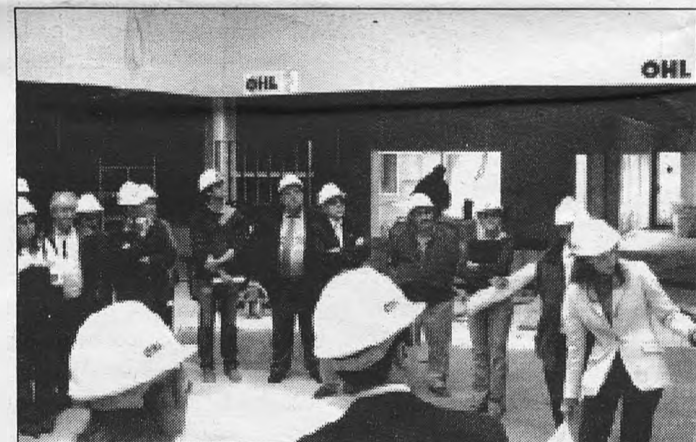
Foto: Angélica Molina El director gerente del SESCAM, Joaquín Chacón, atiende las explicaciones de la arquitecto Gador Carvajal, sobre las instalaciones del nuevo Hospital de Villarrobledo.
