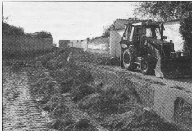
Imagen de las obras de urbanización de la calle-travesía "Canal del Gran Prior".
