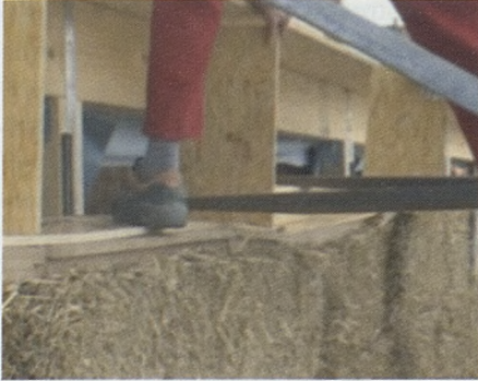
Compresión del paramento
