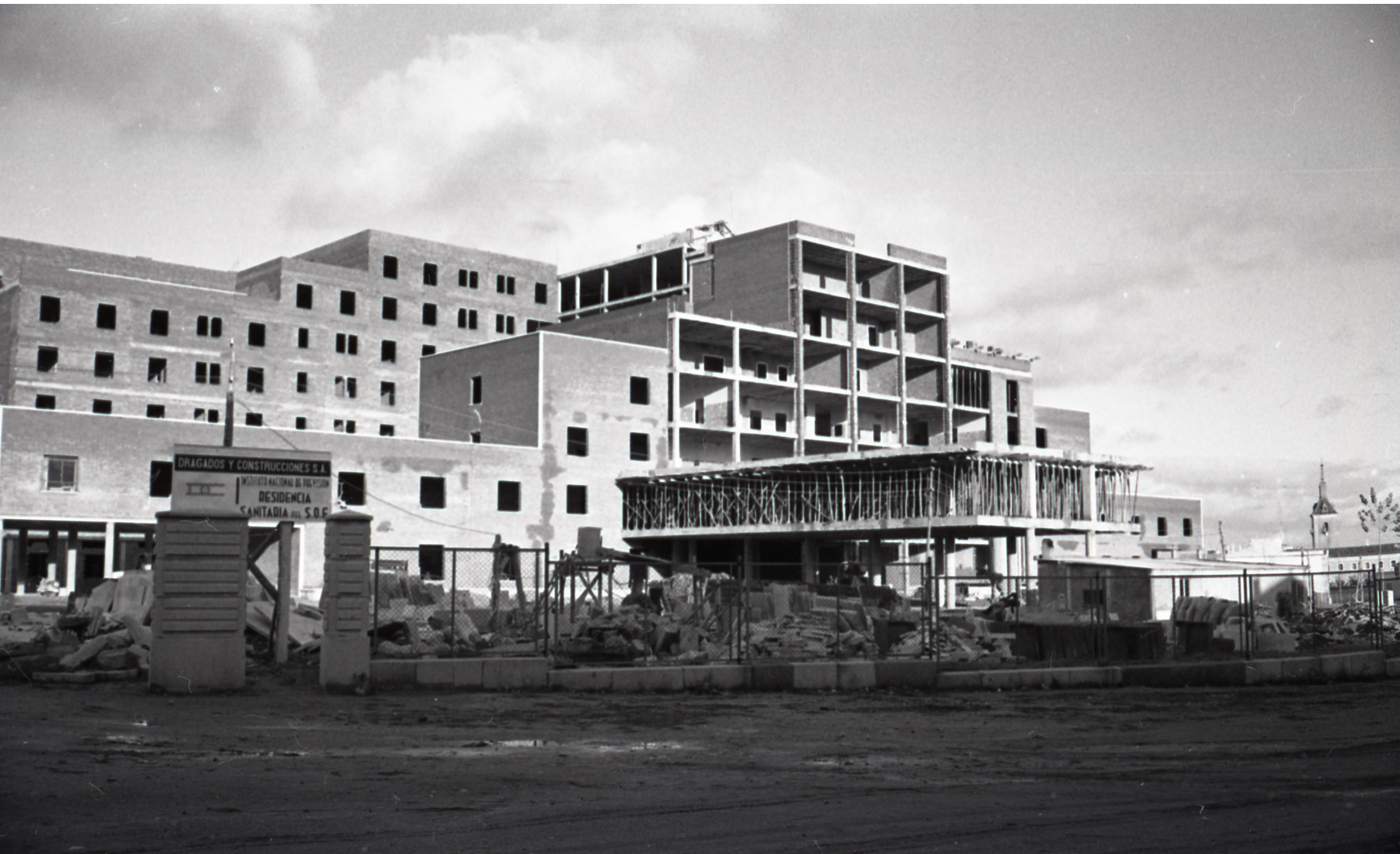
Calle del Beato Fernando de Ayala (Hospital de Alarcos en construcción). 12 de noviembre de 1963
