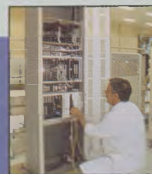
La foto recoge el control eléctrico del sistema Alcatel 1570 NB que manipula uno de los operarios de la fábrica toledana.
