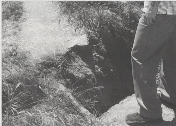
Peligroso socavón que impide el paso por la senda ecológica del Tajo junto al puente de San Martín.
