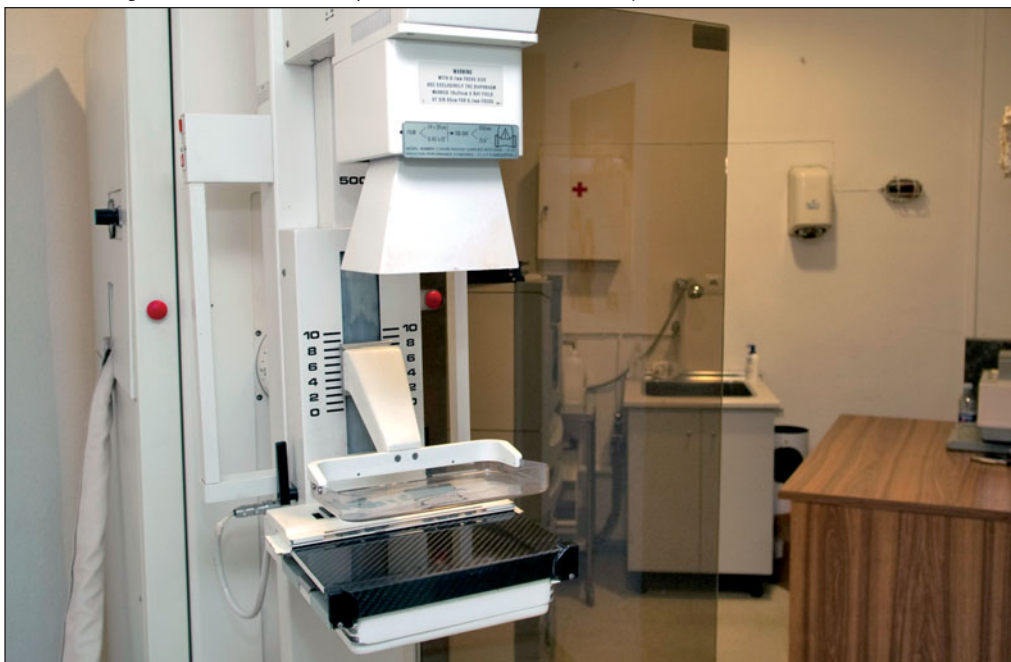
Sala de mamografía instalada en la sede que la AECC tiene en Albacete capital.
