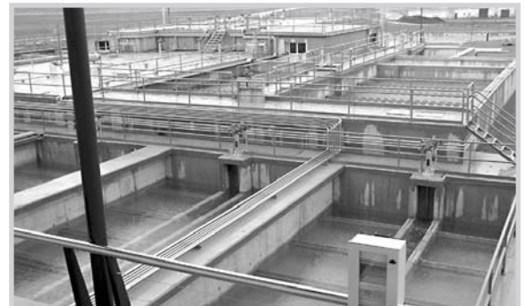
Estación de Tratamiento de Agua.
